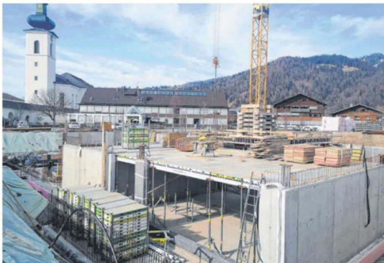
Rege Bautätigkeit beim neuen Schulhaus für Mittelschule und Polytechnische Schule im Ortszentrum.
